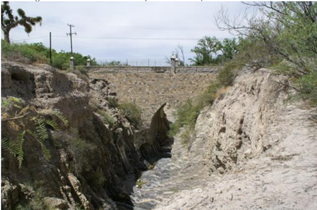
Figura 4-2a Obstrucción en la arroyo Morón Municipio Parras de la Fuente
